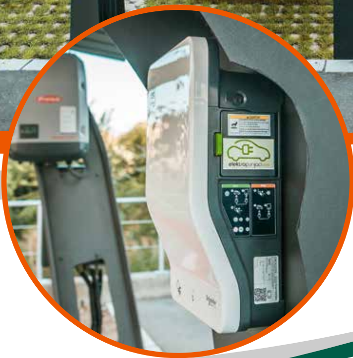
Nadstrešnica sa 2 parking mesta i solarnom elektranom kapaciteta 5 kW
