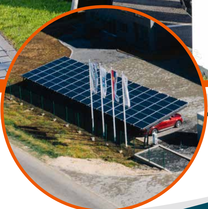
Nadstrešnica sa 10 parking mesta i solarnom elektranom kapaciteta od 24,75 kW
